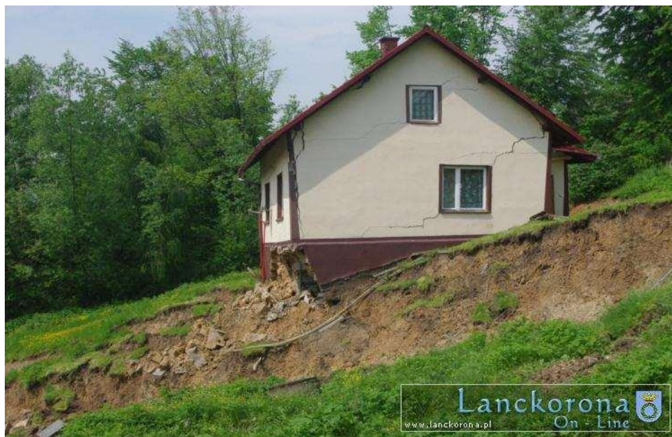
Fotografia nr 3: Osuwisko w gminie Lanckorona
